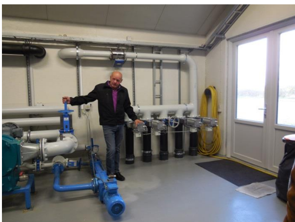
Billede 4: studser til rørledninger til gylle 4
